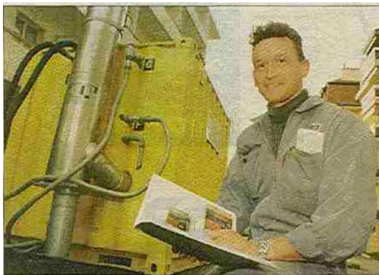
Le Blocochauffage mis au point par Marco Zanichelli permet de dépanner des Immeubles comptant jusqu'à deux cents appartements.
